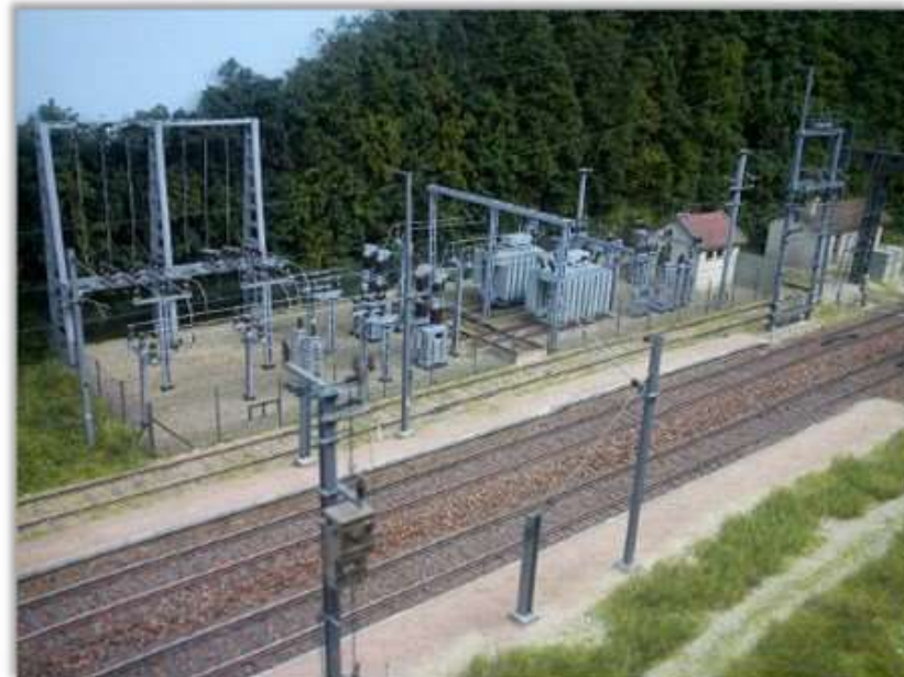
Illustrations : Sous-station 25kV de MESNAY
