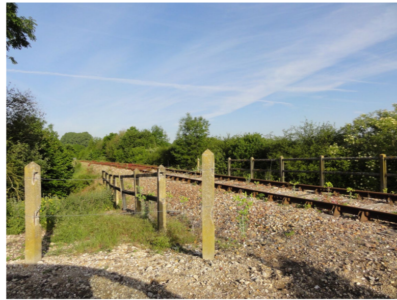
Voie ferrée au niveau la de confluence entre la Seine et l'Eure à proximité de Saint-Etienne-du-Vauvray.
