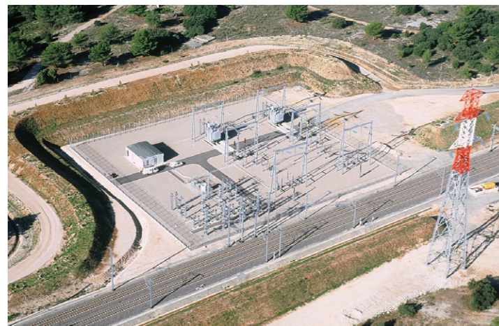
Sous-station pour une LGV. Source: RFF.
